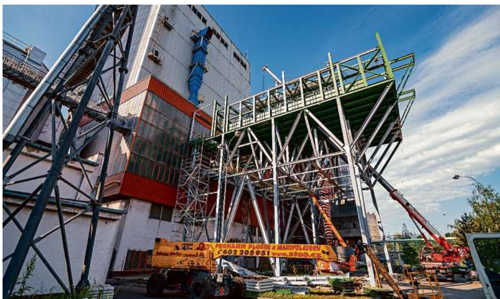
Výstavba nosné konstrukce zásobníku biomasy u nové investice „Navýšení spoluspalování biomasy na kotli K6“
