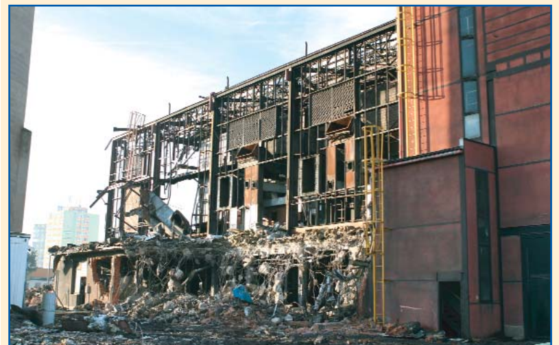
Jako z hororu vypadá Borská výtopna s rozpadanými střechy.
