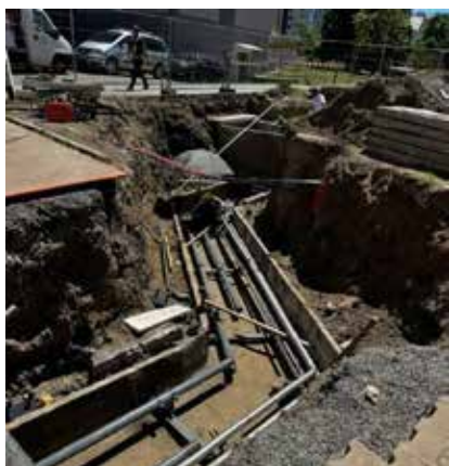
Ulice Mandlova: neprůlezný topný kanál čtyřtrubkového vedení topení a teplé vody
